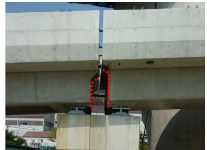
桁端部の切欠き
