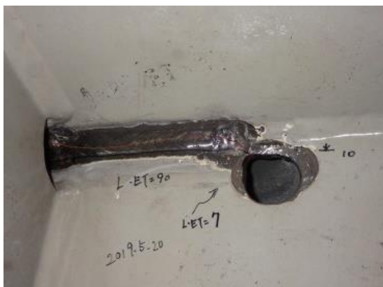
鋼床版の損傷状況
