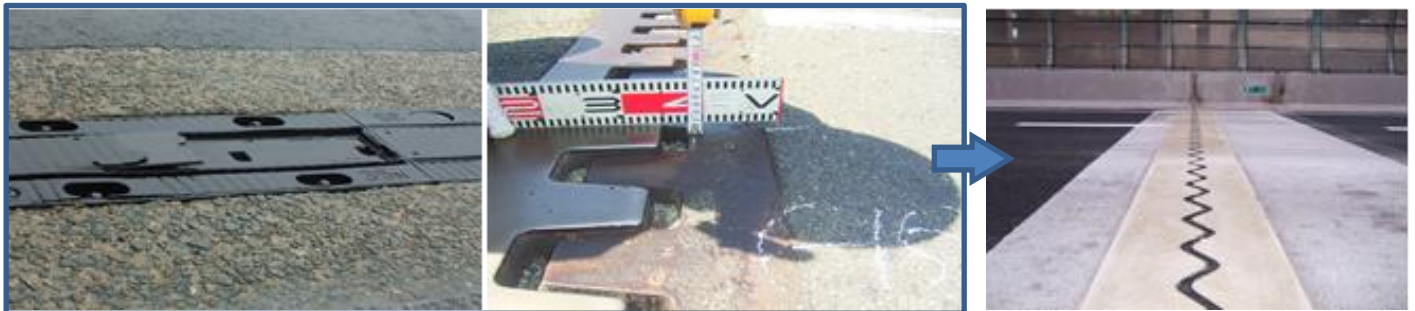
損傷事例(ゴムジョイントのはがれ)
