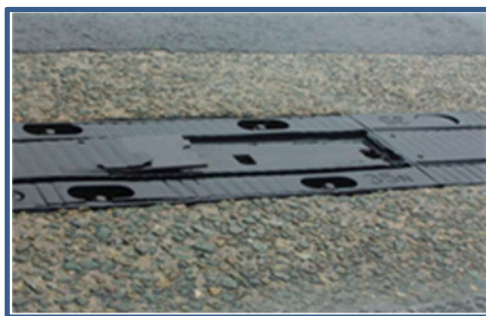
損傷事例(ゴムジョイントのはがれ)
