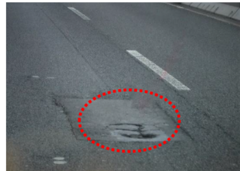
舗装損傷(コンクリート床版の損傷個所)
