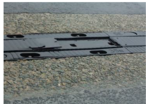
伸縮継手(ジョイント)の損傷
