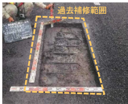
コンクリート床版の損傷(発覚時)
