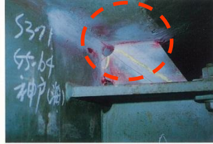
写真-2 タイプ2の損傷
