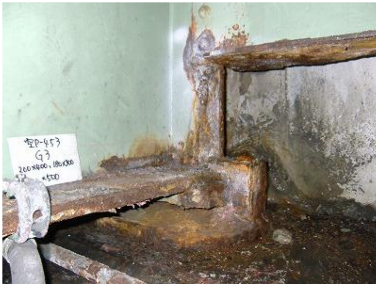
主桁・支承部の腐食事例
