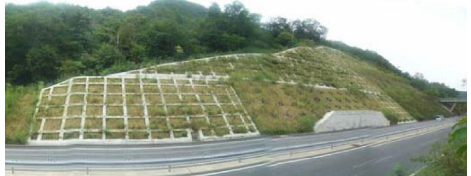
のり面保護工 (吹き付け枠のり面)
