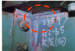
写真-4 タイプ4と1の損傷
