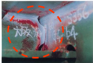
写真-3 タイプ3の損傷
