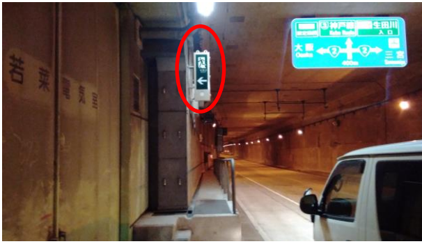
① トンネル本線の誘導表示
