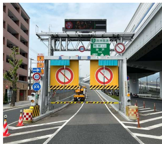
入口遠隔閉鎖装置(西宮入口)
