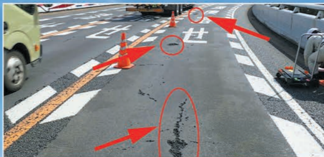
「1号環状線リニューアル工事2020年南行」前の舗装の損傷状況
