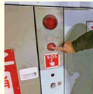
押しボタン式通報装置
