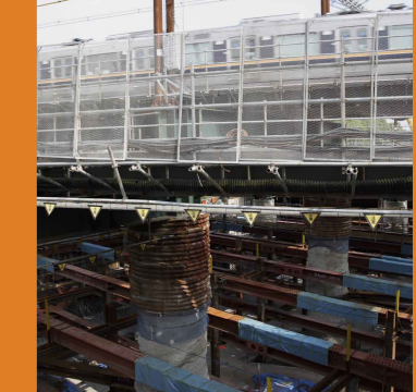
地上を走る線路の下にトンネルを掘るこの工事では、まず線路と電車の重みを支える仮受け杭(写真中央と右奥の杭)を打設してからトンネルをつくり、その後仮受け杭ははずします。
