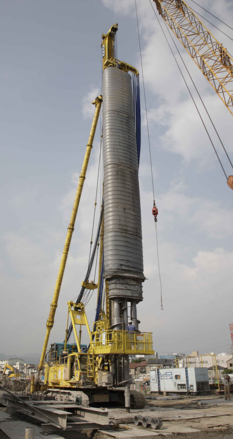
湊川ジャンクション付近の工事現場。写真の機械は土留め壁をつくる際に使われる掘削機(UD-HOMET)。モーターがスクリュ一部に装備されているため従来の機械よりも力が強く、先行削孔が不要なので、工期短縮がはかれる効果があります。
