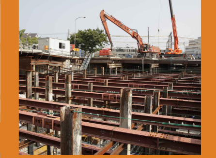
地下鉄線の上部を開削してトンネルをつくるため、高速道路トンネルの地下深度が一番浅い区間。
