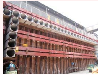
施工事例 (JR鹿児島本線・久留米) Example of similar construction (Kurume, JR Kagoshima Main Line)
