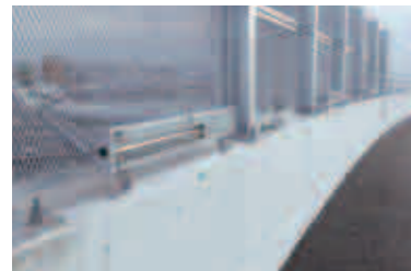
LED高欄照明
