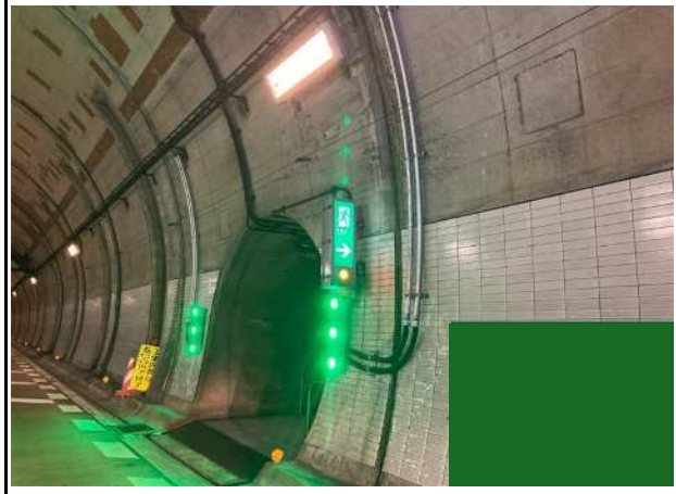
非常口強調灯外観
