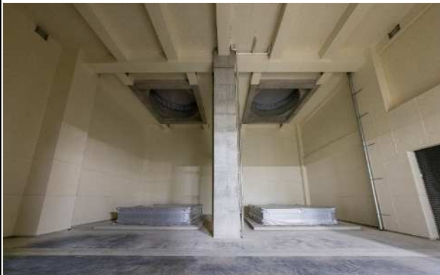
1階 換気ファン室
