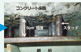
スタッドの露出状況
