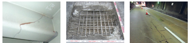
構造物の老朽化が発生
