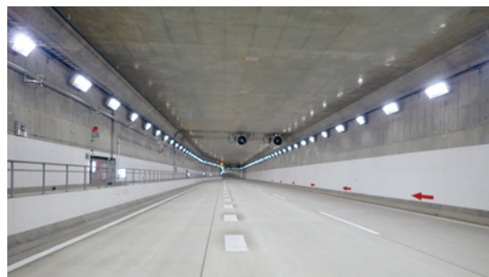
LED道路照明
