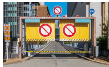
入口遠隔閉鎖装置
