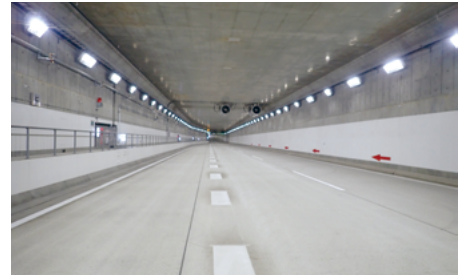
LED化された道路照明
