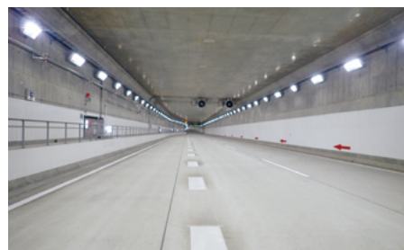
LED化された道路照明
