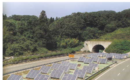
太陽光発電設備 (7号北神戸線長坂山トンネル坑口付近)
