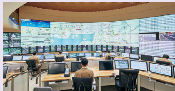
交通管制室(大阪)の状況
