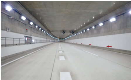
LED化された道路照明
