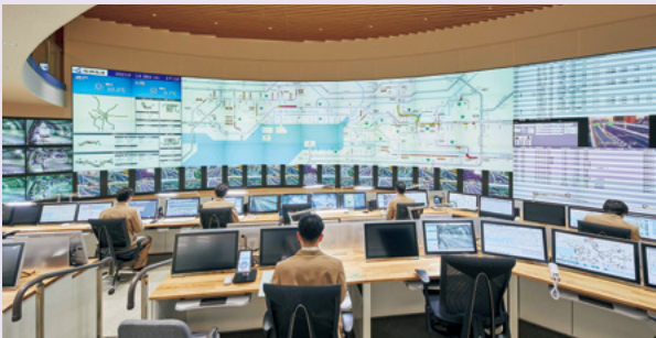
交通管制室(大阪)の状況
