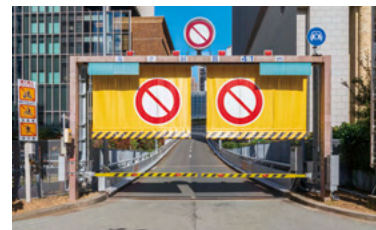
入口遠隔閉鎖装置
