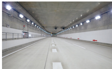
LED化された道路照明
