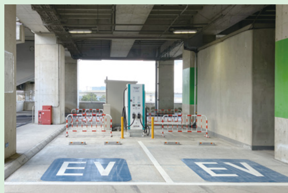
更新された充電器（泉大津PA（海側））
