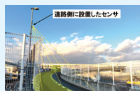
道路側に設置したセンサと検知イメージ
