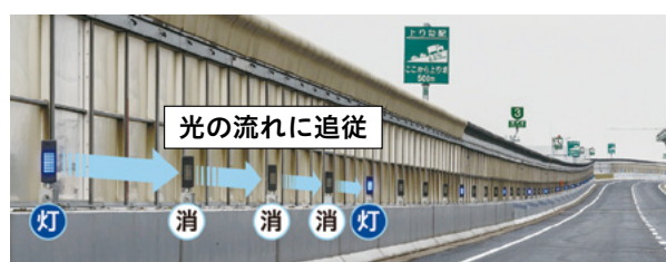
速度回復誘導灯（3号神戸線（東行）深江付近）
