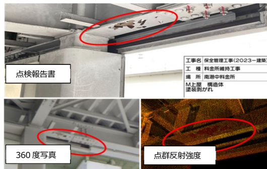
写真-3 塗装剥がれ点検事例
