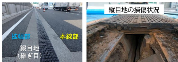
写真-2 縦目地とその損傷状況
