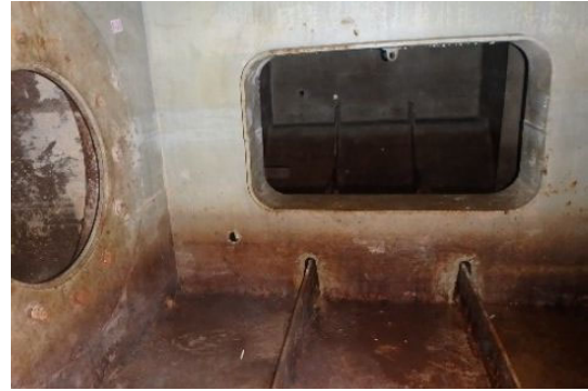
写真-1 鋼製基礎内部の腐食状況
