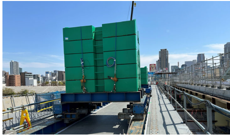
写真-8 移動式カウンターウェイト設備
