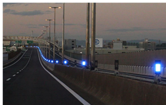
図-7 速度回復誘導灯の設置状況
