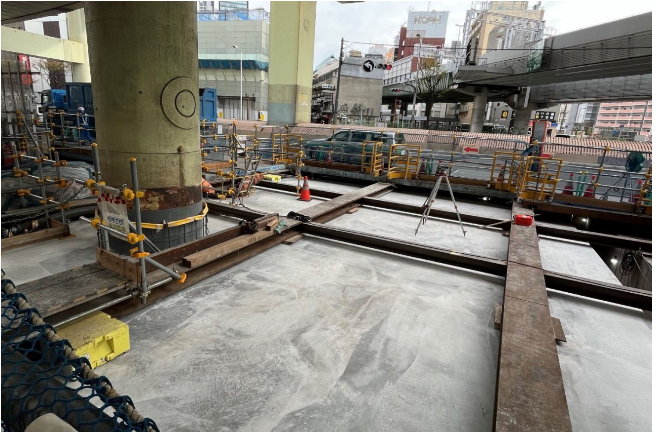
維持管理用空間を確保するため構築した躯体コンクリートの状況（PN-01）
