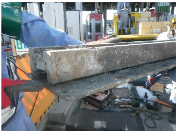
写真-2 棒状センサー外枠の破損例 (溶接部外れ)
