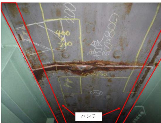
写真-1 下面から撮影した補強鋼板の損傷の例（腐食）
