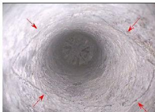
写真-2 全周ひび割れ（内部損傷調査）
