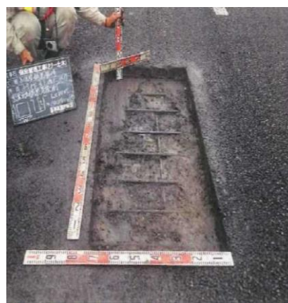
写真-1 コンクリート床版の損傷の状況
