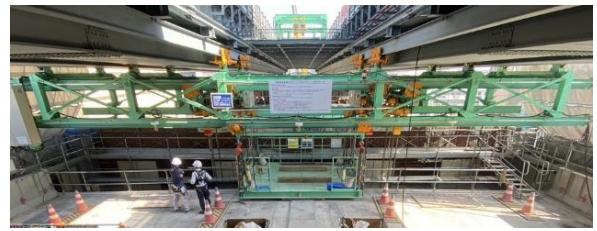
写真-8 サスペンションクレーン
