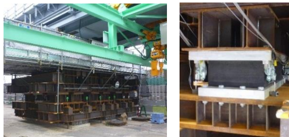
写真-6 脚上ベント(左)と免震支承(右)
