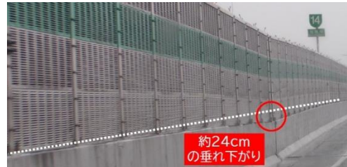
写真-3 橋面上のヒンジ部垂れ下がり状況
