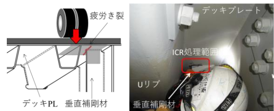
図-1 鋼床版デッキプレートの疲労き裂とICR処理の実施状況
