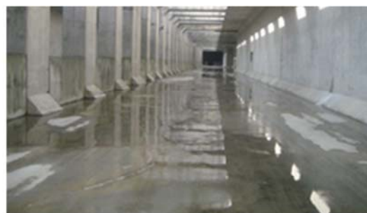
写真-1 不陸箇所や勾配変化点での滞水状況
