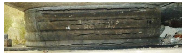
写真-1 劣化支承に発生していたき裂
