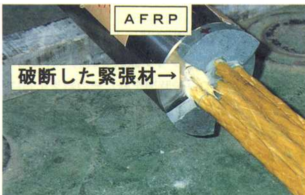
写真-1 緊張材破断状況
