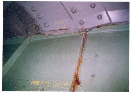
写真-3 補強床版の遊離石灰と錆
