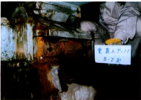
写真-15 ローラー支承のローラーの腐食
