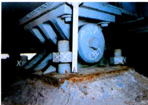
写真-14 アンカーボルトのナット締付け不良
