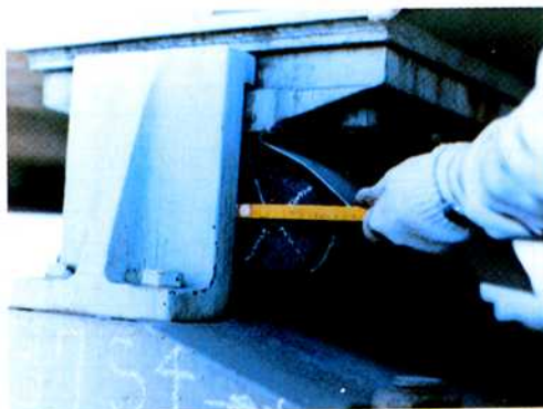
写真-5 ローラーの脱離
