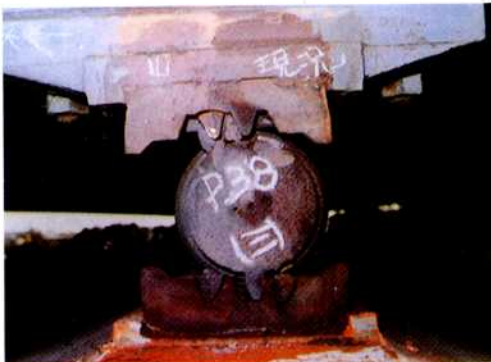
写真-4 1本ローラー支承のピニオンの損傷
