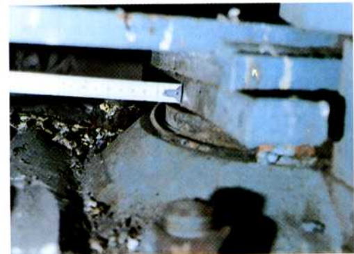
写真-7 支承板支承の支承板のはみだし
