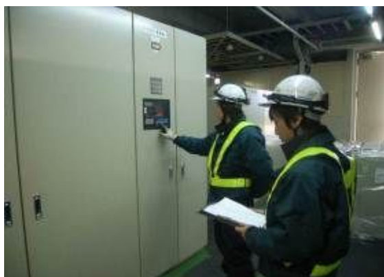
巡回点検（受変電設備）
