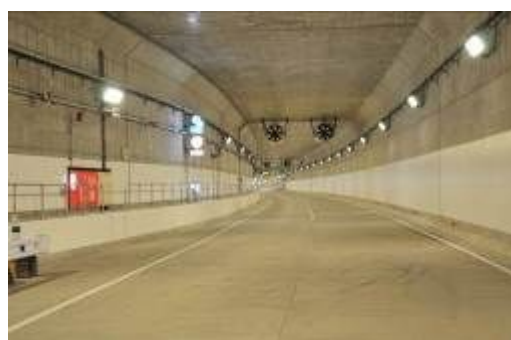
従来型照明(トンネル部)
