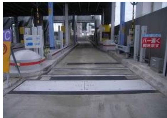
高度化軸重計測装置 設置後
