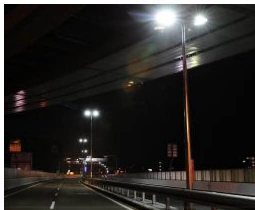
LED照明(明かり部)
