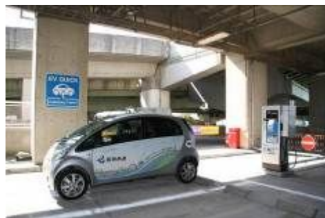
泉大津パーキングエリアに設置した電気自動車用急速充電器
