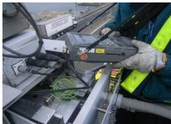
機能点検（交通流監視カメラ）
