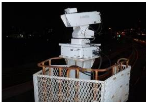
交通流監視カメラ取換前
