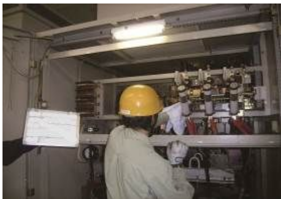
定期点検（受電所）
