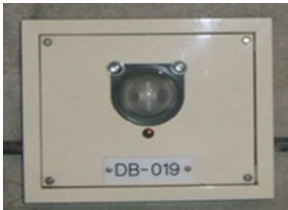
火災検知器 取換前
