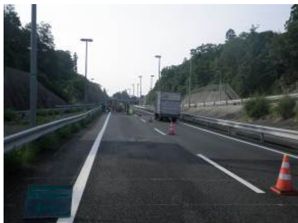
路面損傷状況(施工前)
