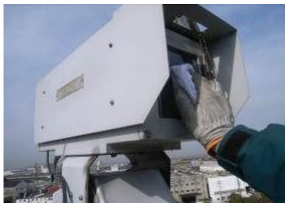
機能点検（交通流監視カメラ）
