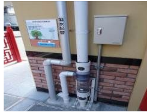
雨水再利用設備
