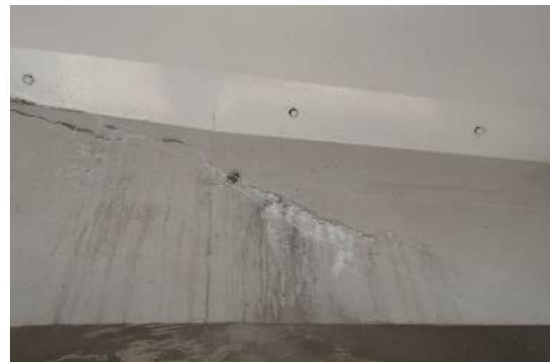
ひび割れ、漏水・遊離石灰（Aランク）
