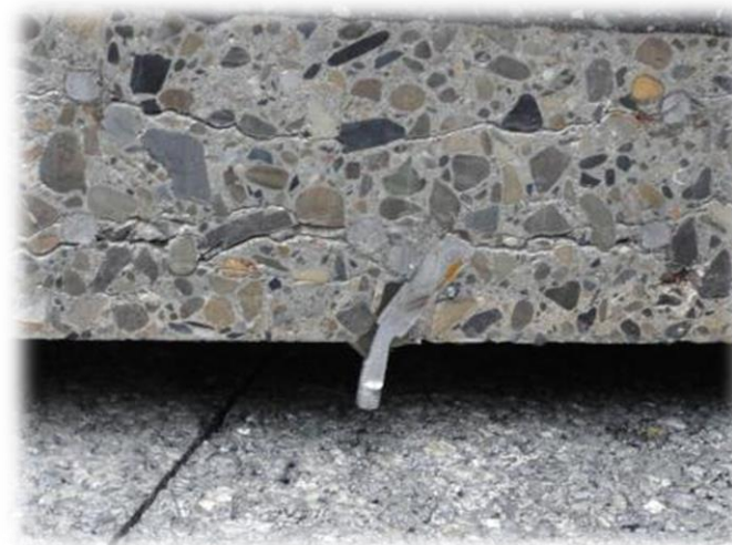
切断面及びひび割れ発生状況
