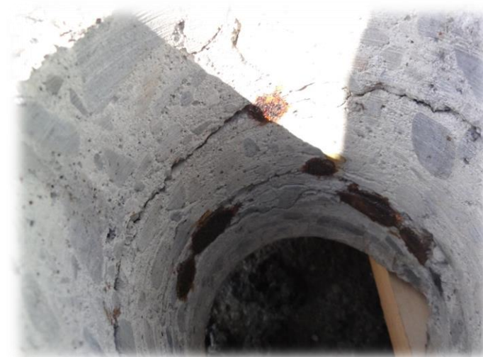
コア孔部の床版内面ひび割れ状況
