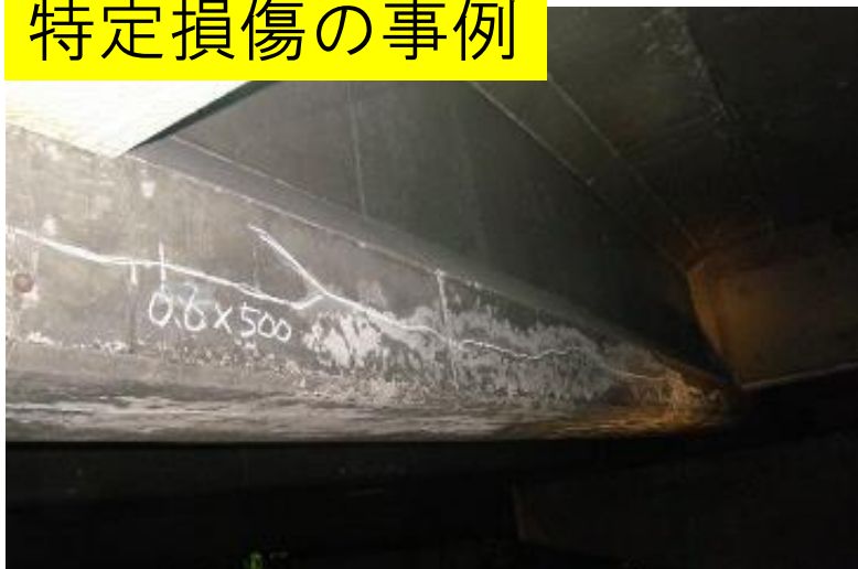
ひび割れ（Aランク）
