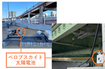
ペロブスカイト太陽電池の性能確認状況
