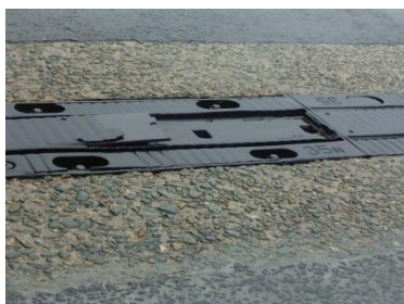
ジョイントの損傷 (ゴムのはがれ)
