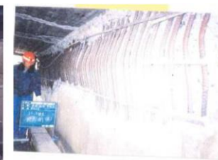
【神 P442（終点側）損傷状況】
