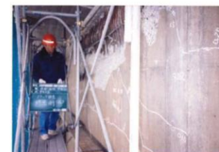
【神 P443（終点側）損傷状況】
