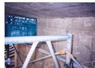
【神 P441（終点側）損傷状況】
