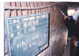
【神 P444（終点側）損傷状況】
