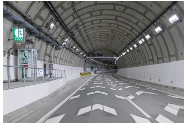
LED道路照明(トンネル内)
