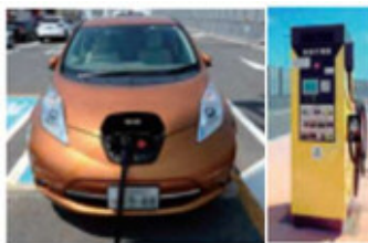
パーキングエリアに設置の電気自動車用急速充電器
