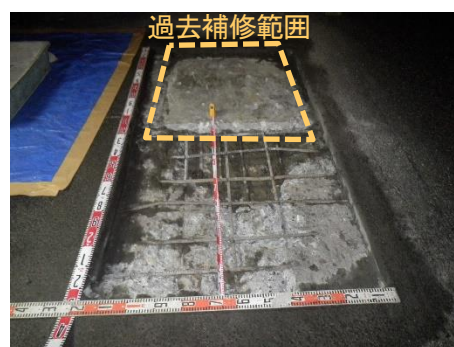
コンクリート床版の損傷（損傷範囲の拡大）
