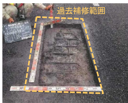
コンクリート床版の損傷（発覚時）
