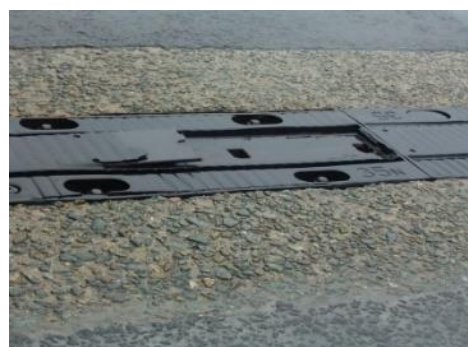
伸縮継手（ジョイント）の損傷
