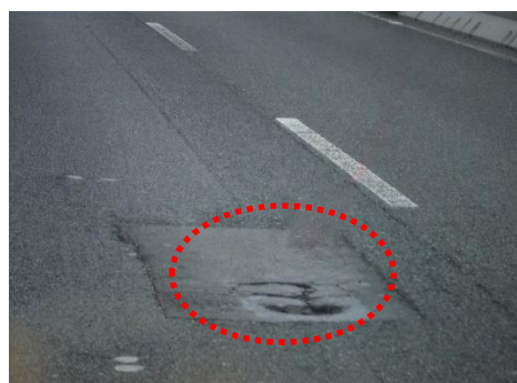
舗装損傷（コンクリート床版の損傷箇所）
