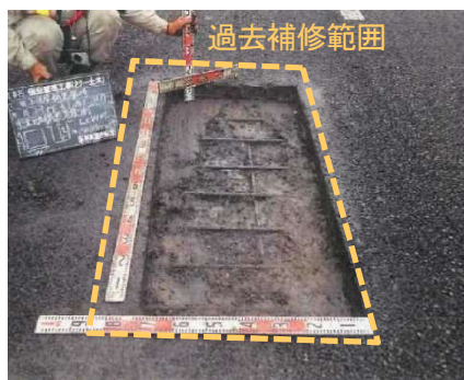
コンクリート床版の損傷
