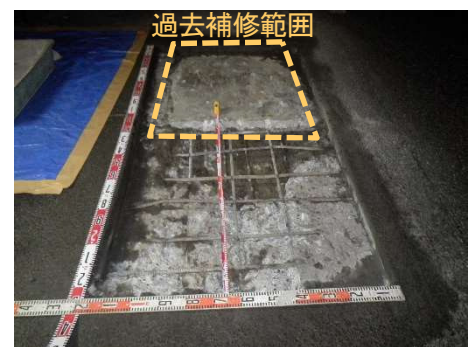
コンクリート床版の損傷(損傷範囲の拡大)
