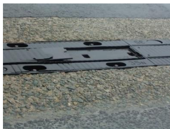
伸縮継手の損傷事例 （ゴムのはがれ）
