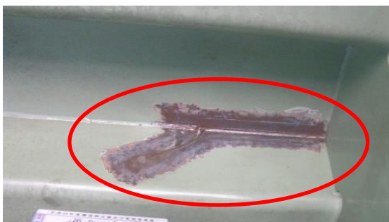
鋼床版 き裂状況
