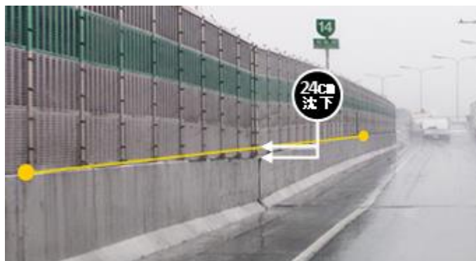
橋桁中央部の沈下状況
