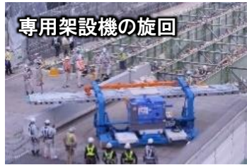
専用架設機の旋回 所定位置へ運搬するために UFC 道路橋床版を把持したまま旋回
